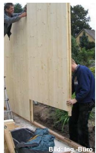
Abb. 56 Bei schmalen Wandtafeln (hier 1,25 m) kann die Verbindung mit einer Fremdfeder aus Sperrholz erfolgen (siehe Folgesseite oben, rechtes Bild). Der Überstand der Sperrholzfeder dient als Zapfen und Anschluss zur Schwelle.
