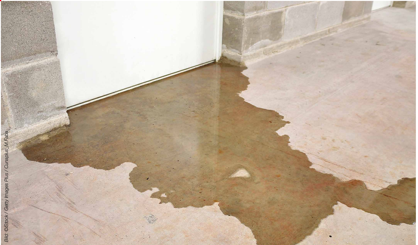
Feuchteschäden an der Zarge im Neubau durch stehendes Wasser
