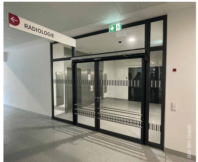
2-flügelige Fluchttür mit Panikfunktion, Zugangskontrolle und Schließfolgeregelung
