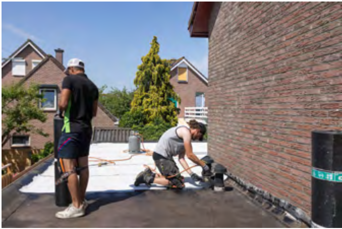
Die Sanierung undichter Flachdächer kann teuer werden
