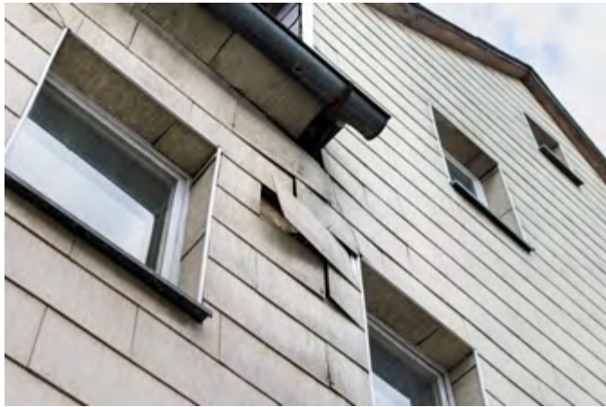
Fassadenplatten aus Asbest, ein Fall für den Fachmann
