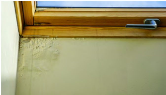
Undichtes Dachflächenfenster – Ein Fall für den Dachdecker
