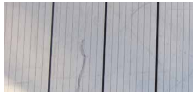
Auf WPC-Terrassen können Kratzer durch Möbelgleiter entstehen.
