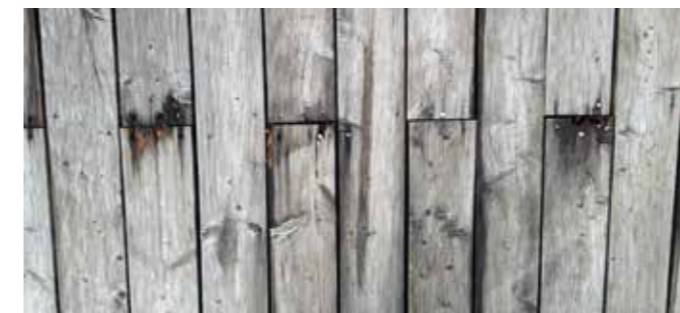
Die Ausführung von Längsstößen auf nur 1 Unterkonstruktion ist nicht fachgerecht.
