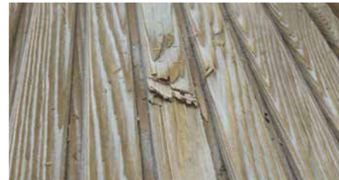
Ringschäle und Schilferissen können auf der rechten Seite der Dielen entstehen.
