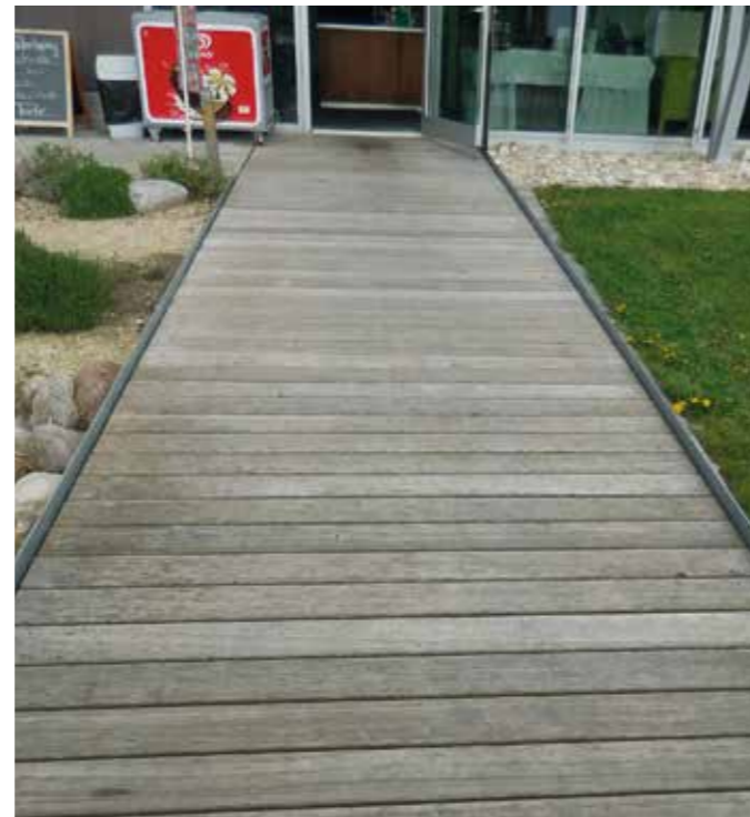
Rampe mit Randabweisern im öffentlichem Bereich.
