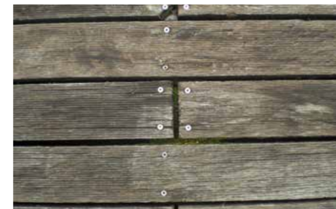
Moos und Dreck in den Fugen führt zur Pilzbildung und zum vorzeitigen Ausfall von Dielen.
