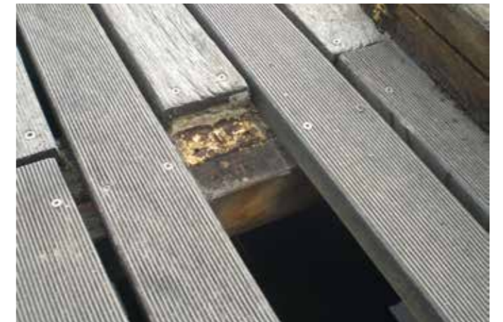
Die Ausführung auf nur 1 Unterkonstruktion führt zu einer Pilzbildung.
