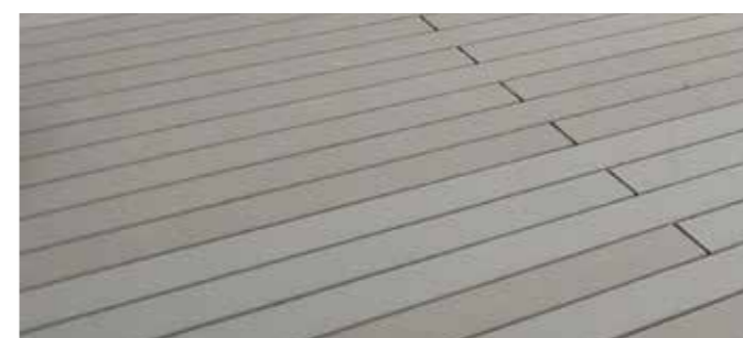
Farbunterschiede durch Nichtbeachtung der Verlegerichtung.
