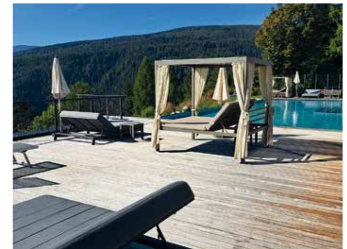
Im überdachten Bereichen von Terrassen kann die Vergrauung unterschiedlich stark ausfallen und teilweise unschön wirken.
